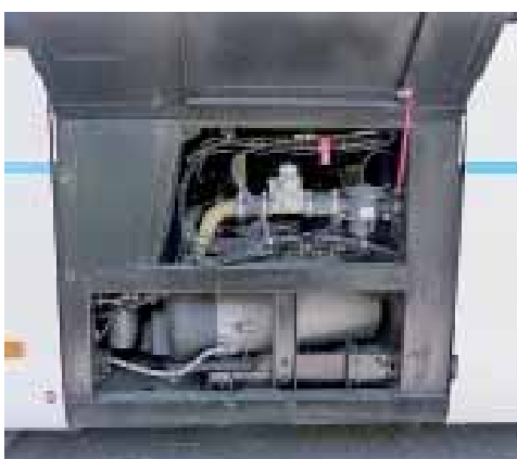
Die ölgefeuerte Zusatzheizung im Capacity L sorgt dafür, dass die Insassen nicht frieren, auch wenn der Dieselmotor nicht genügend Abwärme erzeugt.
