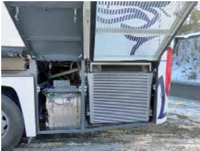
Hinten links befinden sich Kühler und Abgasnachbehandlung.
