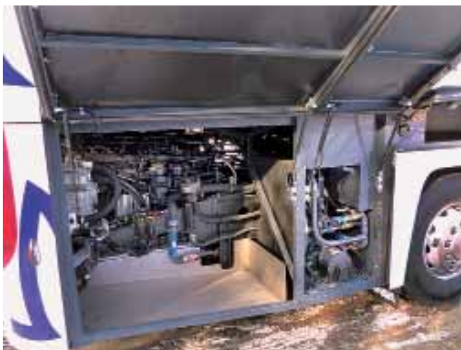
Als Reisebus ist der HD auch mit Hecktür und Hecktoilette zu haben. Platz ist dafür vorhanden, in diesem Fall wird die Standheizung (Spheros DW 300) an anderer Stelle eingebaut. Sie ist bei dieser Ausführung mit Mitteltür in einem separaten Fach rechts sauber untergebracht.
