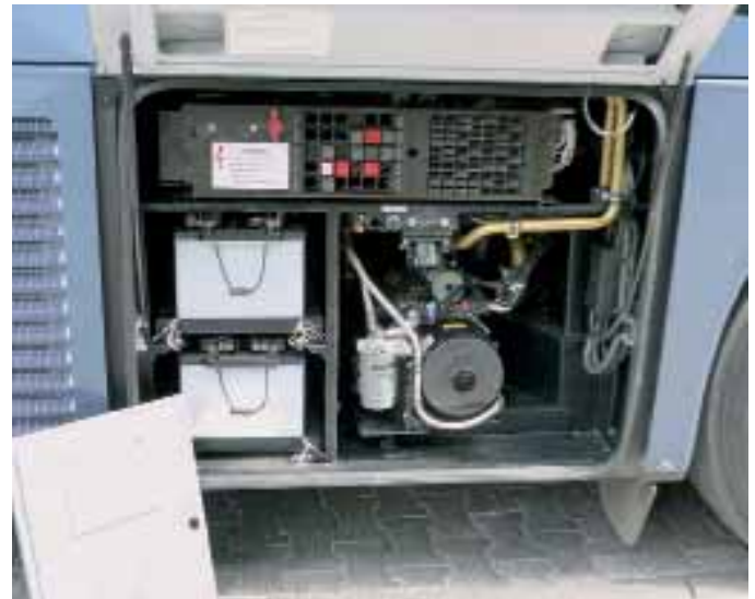
Batterien, Zusatzheizung und Sicherungen befinden rechts sich hinter der Hinterachse.
