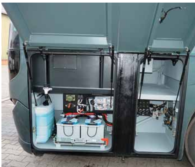
Nicht immer beliebt ist die Anordnung der Batterien so weit vorne im Crashbereich.
